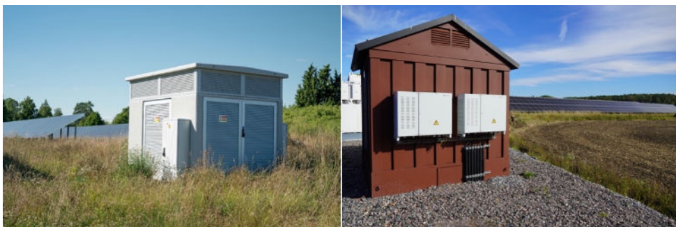
Figur 9. Exempelbilder på transformatorstationer (Solkompaniet, 2024).
