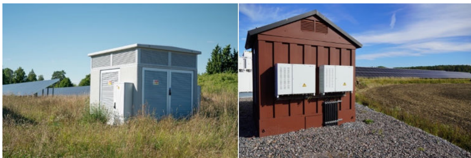
Figur 10. Exempelbilder på transformatorstationer (Solkompaniet, 2024).
